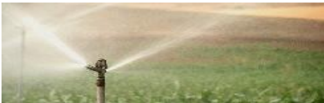
Instal·lacions de reg
